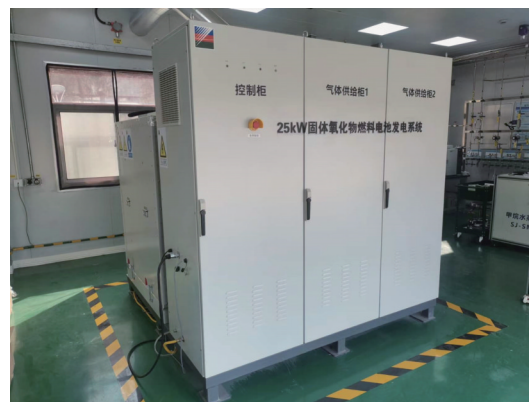
图1 25 kW SOFC发电系统
