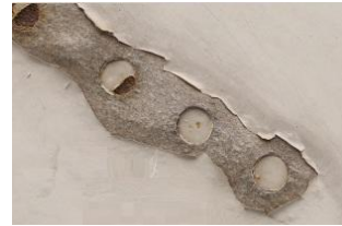
图3 蒙皮表面剥层腐蚀图像
