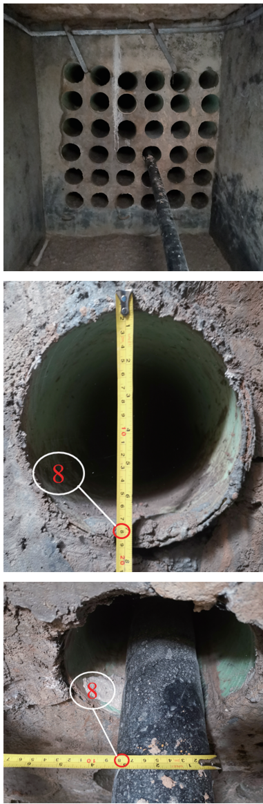
图 1 现场采集的地下排管电缆 Fig. 1 Underground pipeline cable drawings collected on site
